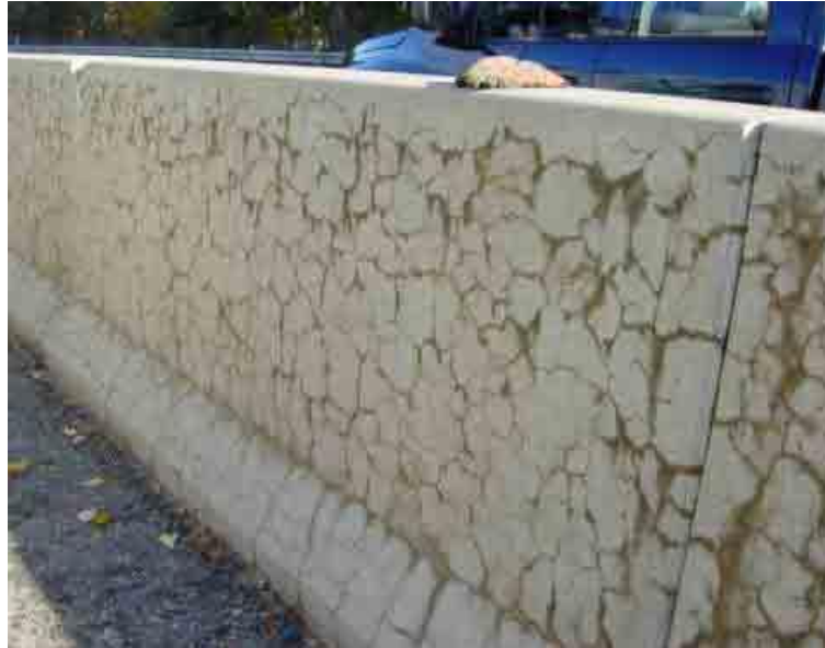
Figure 1.5 – Effet de l’alcali-silice sur une barrière en béton.
