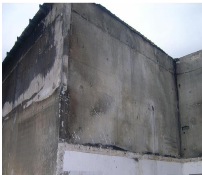
Figure 1.12 – Structure en béton armé dégradée par le feu.
