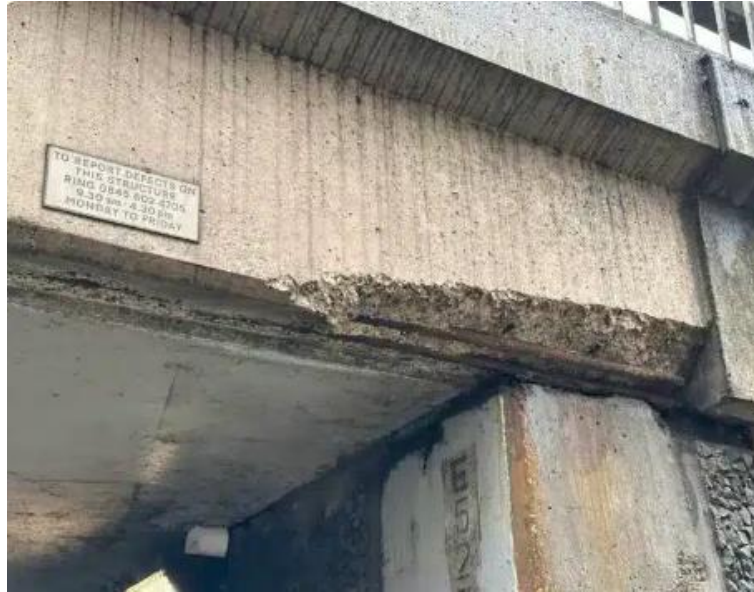
Figure 1.11 – Ouvrage en béton altéré sous l'effet de la fatigue.
