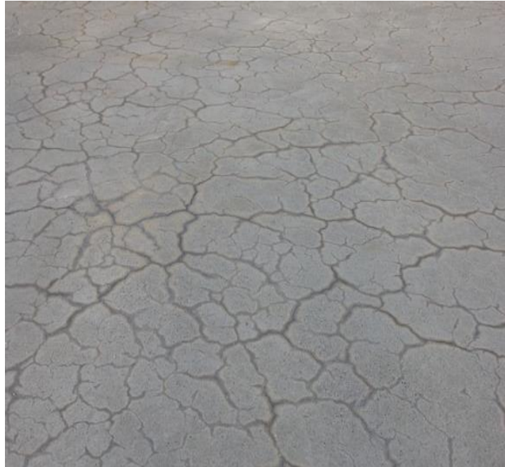
Figure 1.9 – Motif typique de fissures de retrait plastique dans une dalle de béton.
