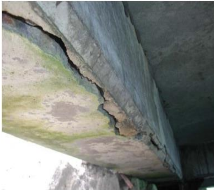
Figure 1.10 – Ouvrage en béton altéré sous l’effet des chocs.
