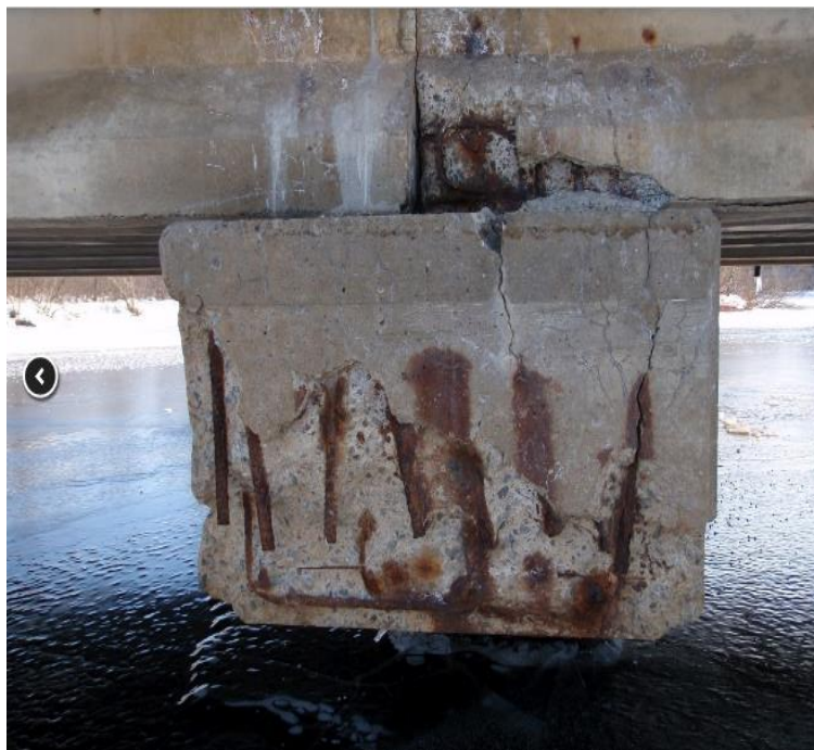
Figure 1.4 – Structure en béton armé sérieusement altérée par les sulfates.
