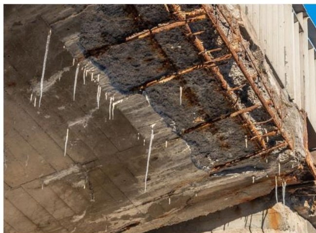
Figure 1.7 – Altération d'un ouvrage par des cycles de gel/dégel.
