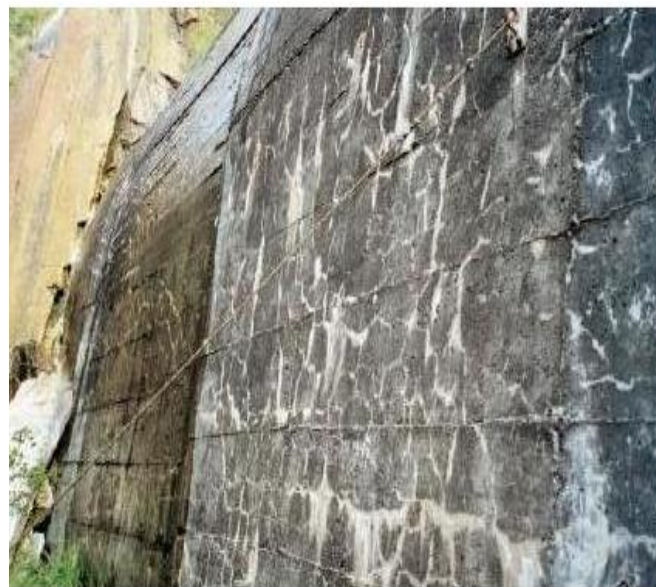
Figure 1.6 – Effet de l’alcali-carbonate sur un mur d’entrée d’un tunnel.
